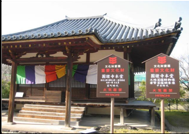
本堂裏の消火器(左)、敷地内の消火用ホース
