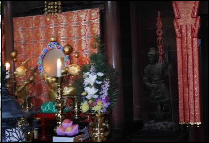
本堂内陣格天井の火災感知器
