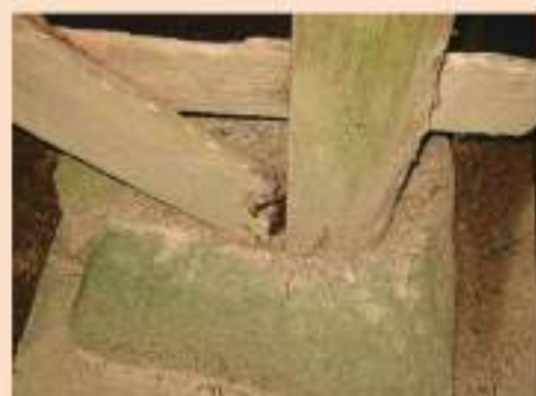
シロアリのため柱が腐食した県指定建造物の平尾水分神社本殿 （宇陀市で2018年5月）
