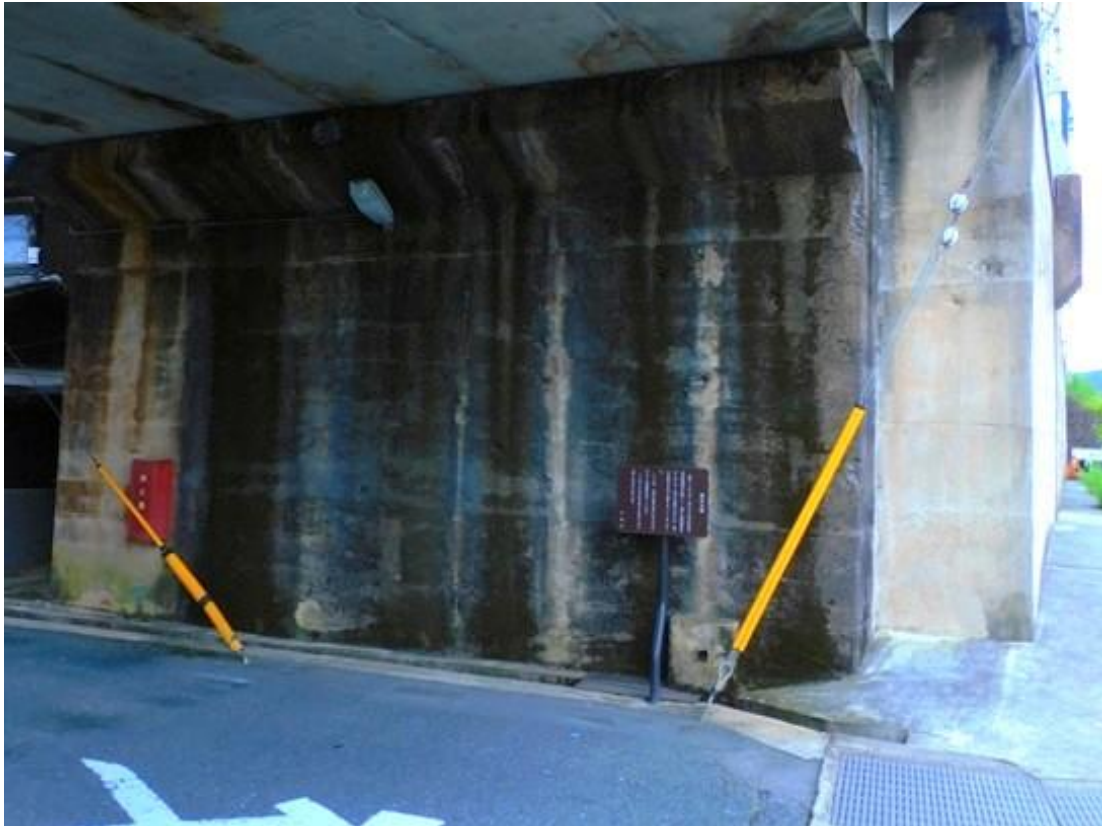
高架の近鉄大阪線の下を横切る道路のコンクリート壁に機銃掃射の弾痕が今も生々しく残る
