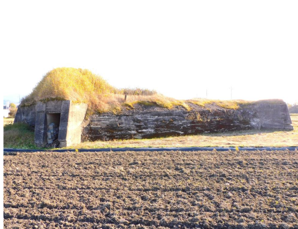
コンクリートが露出し、一部で劣化が進む北側の防空壕＝同
